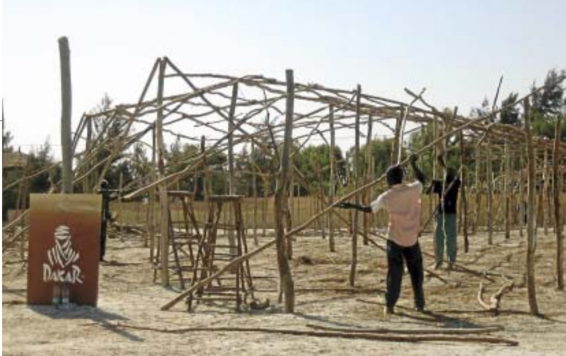
Algunos operarios desmontan los chamizos que habitualmente ocupan las carpas de las marcas participantes.
